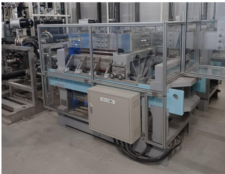
【納入した水素製造装置：水素発生量：200N m 3 /h】
