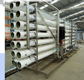
ROユニット
