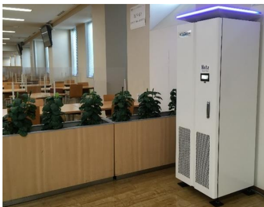
【日立造船本社の食堂に設置】
