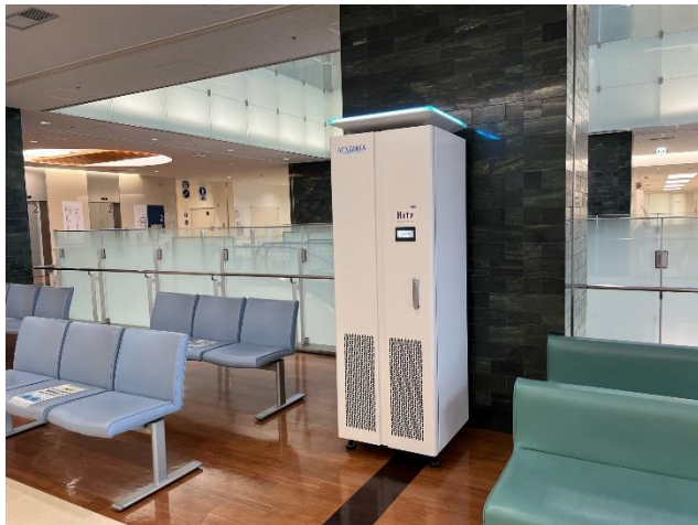
【徳島県立中央病院の待合スペースに設置】
