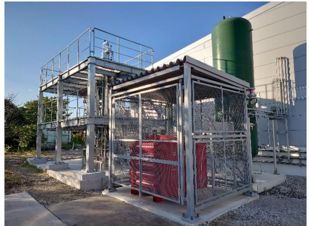
【メタネーション実証設備外観】
