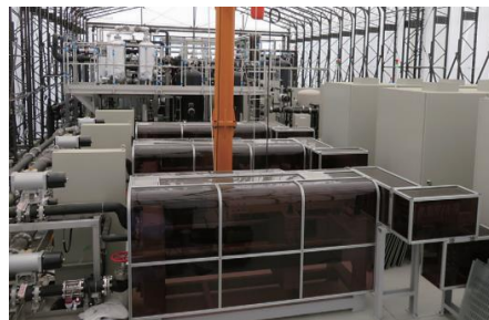
水素製造装置
